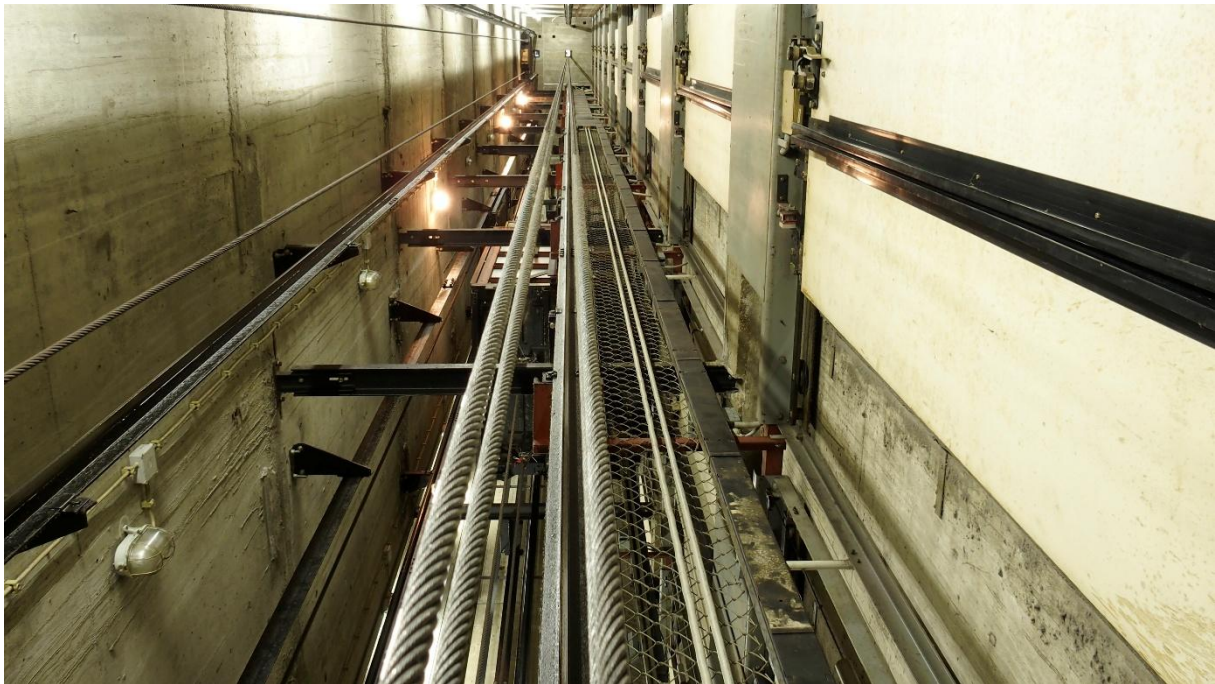
Bild 1: überwachungsbedürftige Aufzugsanlage, Quelle: iStock-Fotografie-ID:1053586122, Wolfgang Beck
